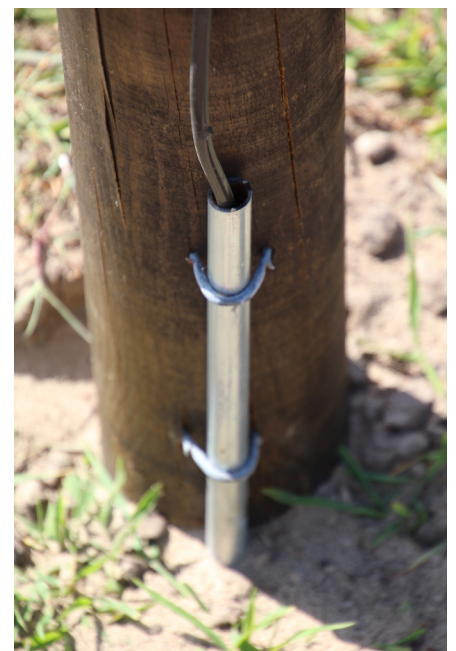
Grondkabelpijpje met draadkram
